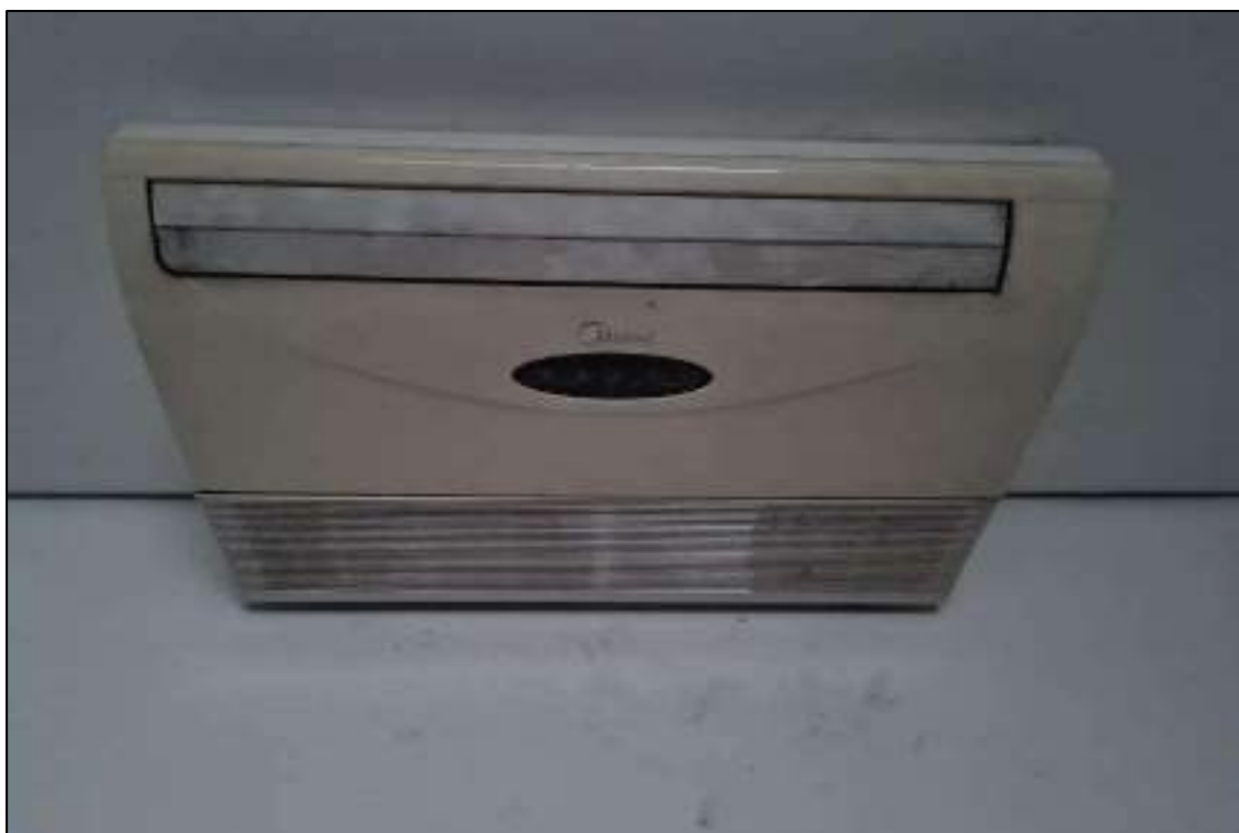
ITEM 0131 - AR-CONDICIONADO SPLIT – MIDEA
