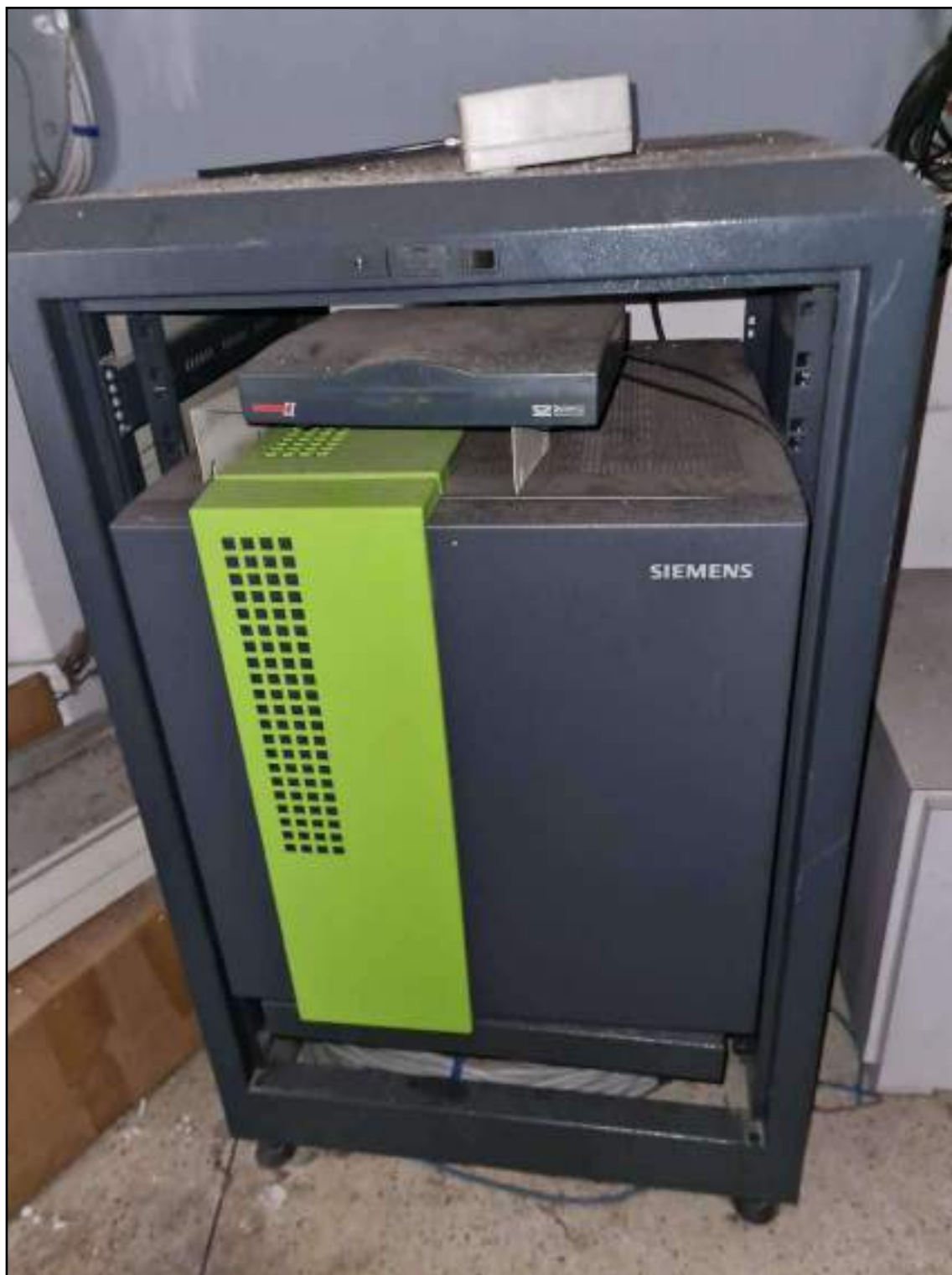
ITEM 0247 - SERVIDOR PARA DISTRIBUIÇÃO DE CABOS TELEFÔNICOS
