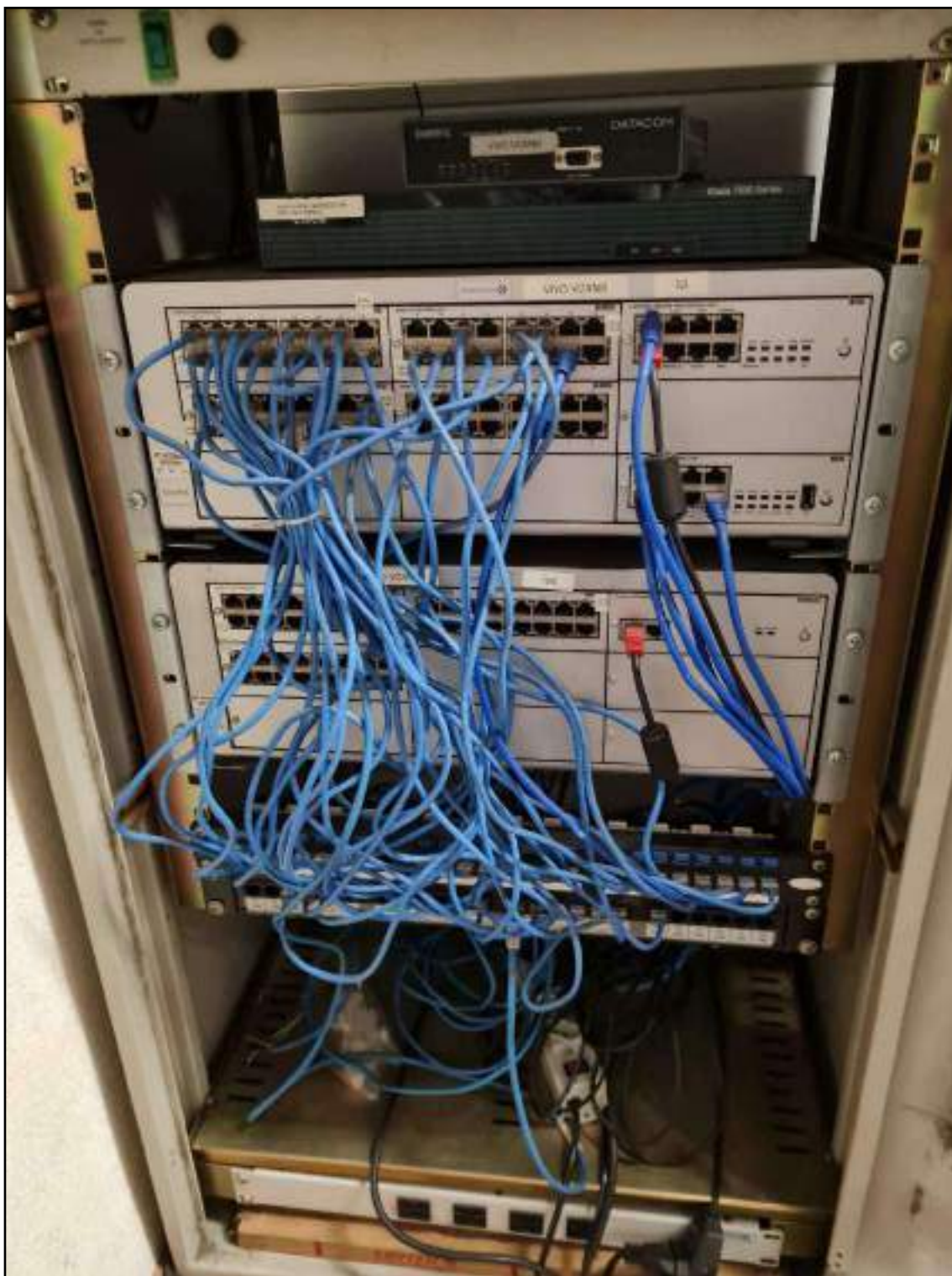
ITEM 0213 - SERVIDOR CENTRAL PARA DISTRIBUIÇÃO DE CABOS DE TEFEFONE E INTEMET
